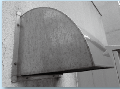
写真3 都心のマンション敷地内にあるポンプ室壁面のステンレス製排気フード (No.8) ※に発生した錆
