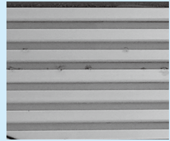
⑤【複合皮膜】都心にあるビルの玄関の軒天井（竣工後2年）。点食が発生している
